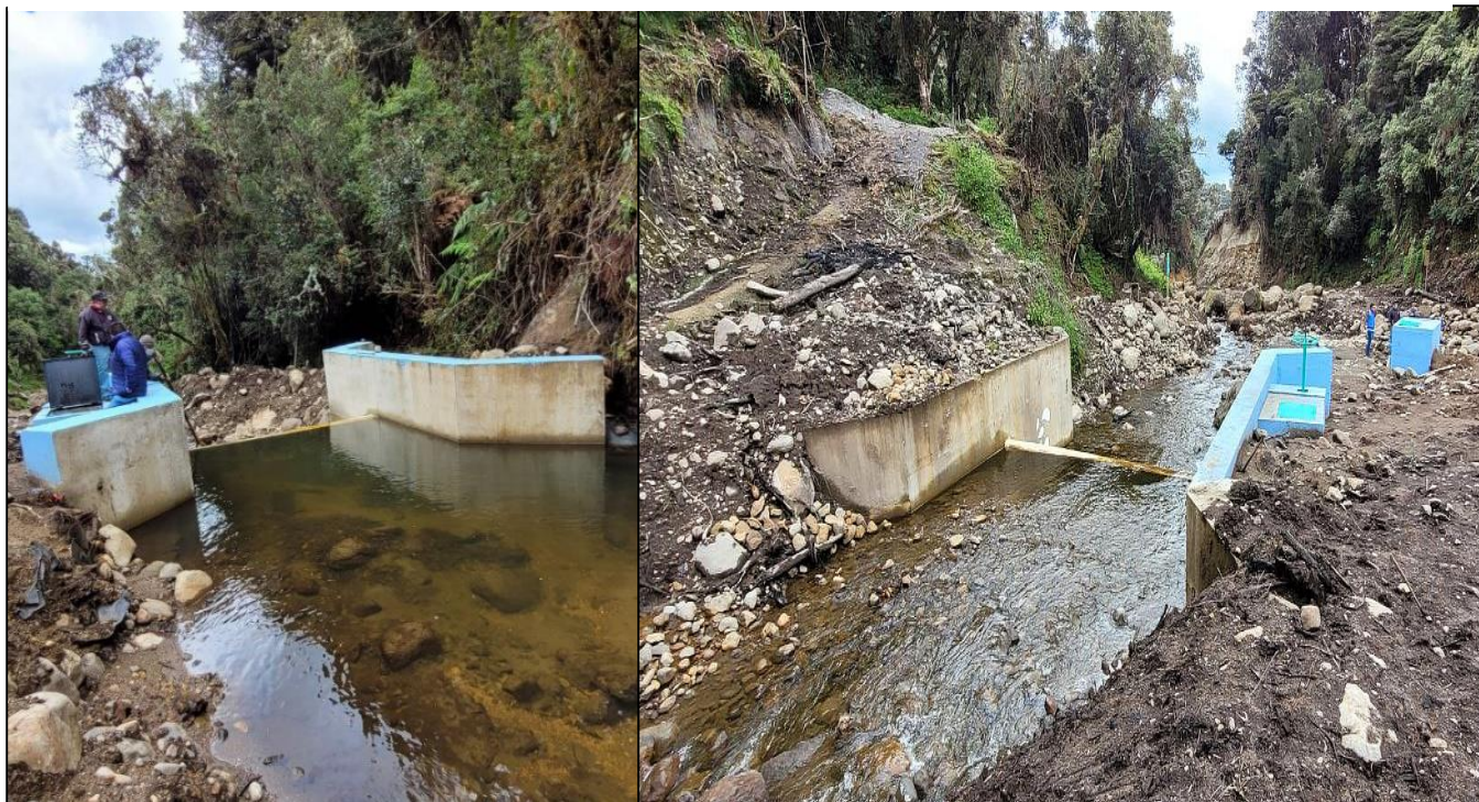
Ilustración 36 Estructuras de las captaciones Chingual y Machines operando
