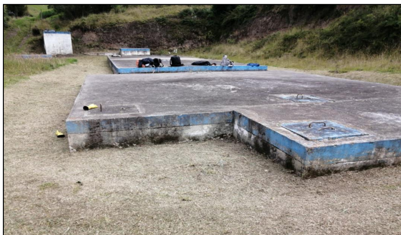
Ilustración 40 Planta de Tratamiento Vivienda Popular.
