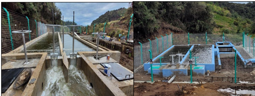
Ilustración 35 Estructura del sedimentador totalmente operativo
