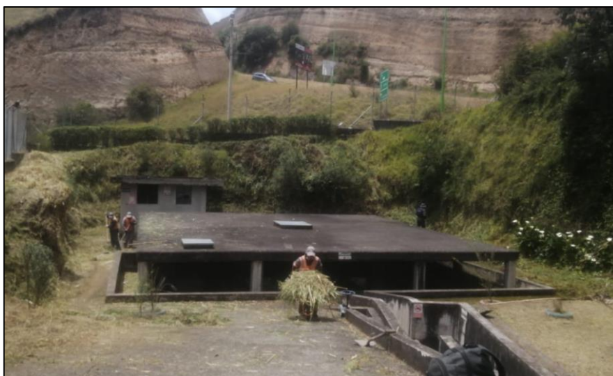
Ilustración 39 Planta de Tratamiento Tres Chorros. (inoperativa)
